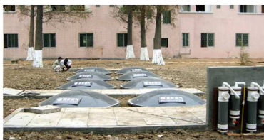
Unité de traitement des eaux usées de 500 personnes alimentant un restaurant
