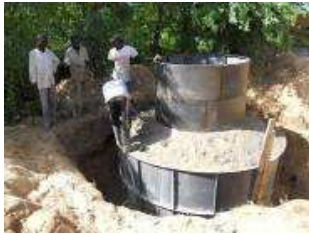
Unité individuelle zone rurale produisant énergie pour la cuisson et l'électricité (groupe 600 w)
